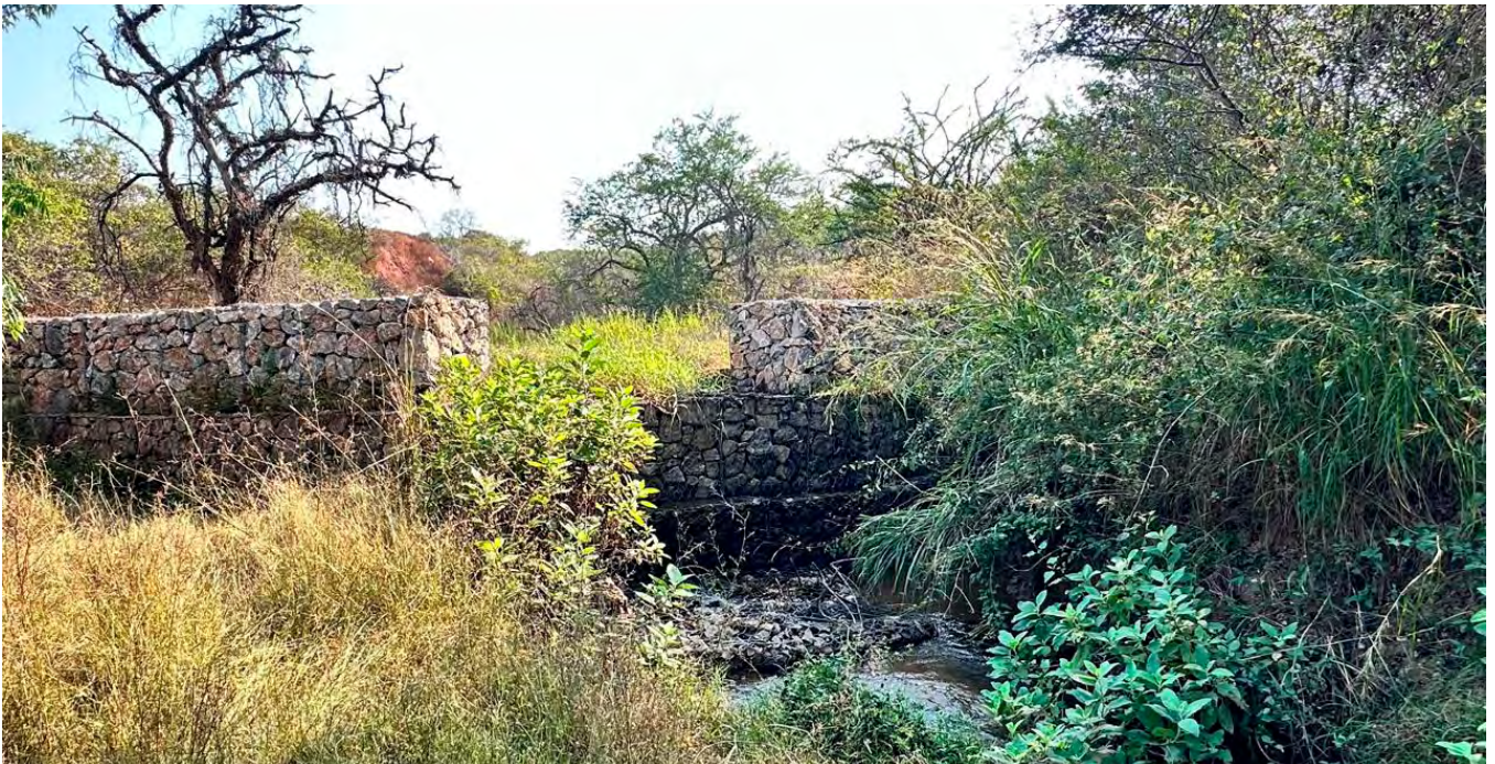
Represa totalmente llena de azolve.
