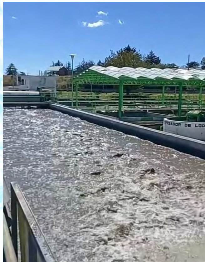
Proceso de tratamiento de aguas residuales en planta Jocotitlán, donde se extraen lodos usados como fertilizante.
